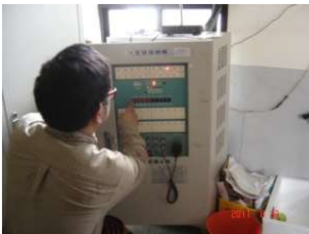
廣播主機電池及線路查修(改善前)
