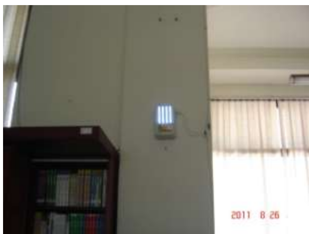
緊急照明燈(更新)
