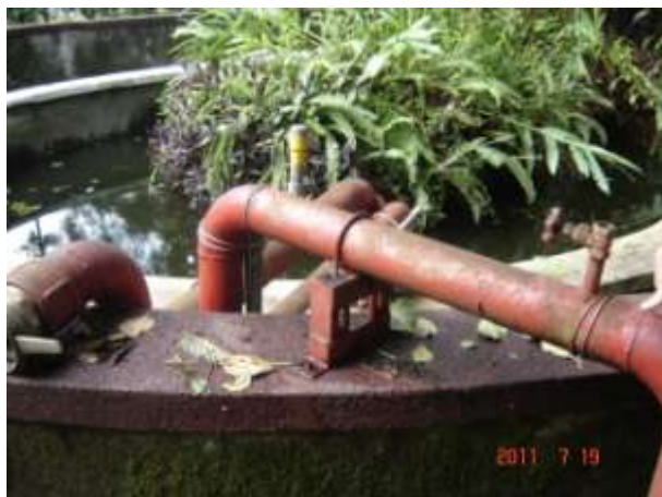
消防管路除銹油漆(改善前)
