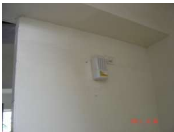
緊急照明燈(更新)
