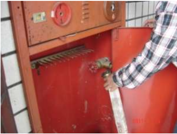
消防栓箱除銹油漆(改善前)
