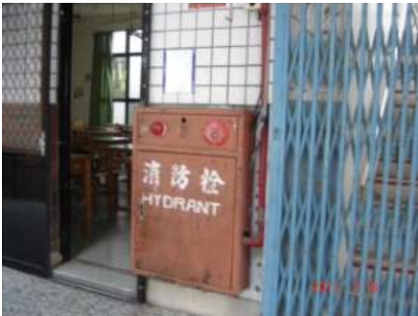
消防栓箱除銹油漆(改善前)
