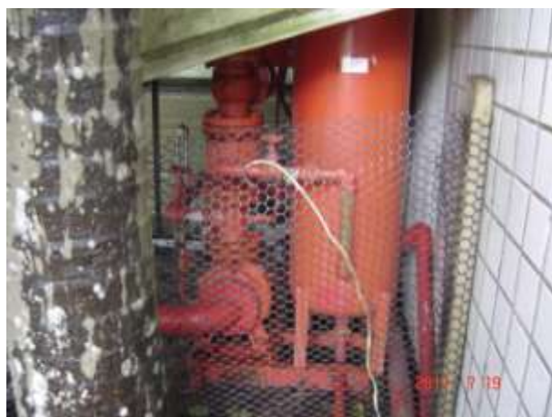
消防管路除銹油漆(改善前)
