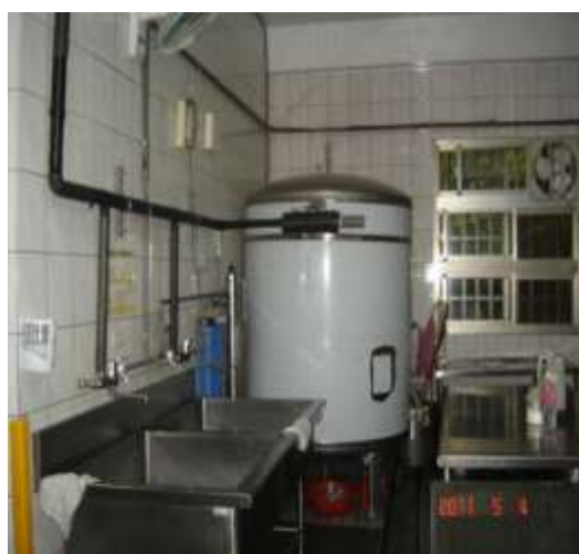
熱泵熱水器(改善後)
