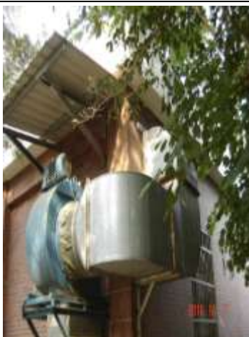
抽油煙設備(改善前)
