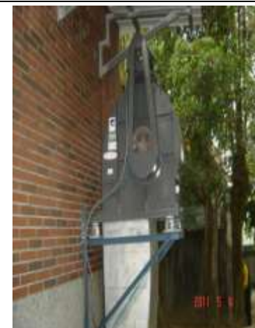
抽油煙設備(改善後)
