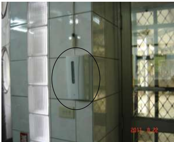
廚房安裝洗手設備-自動消毒洗手機(改善後)
