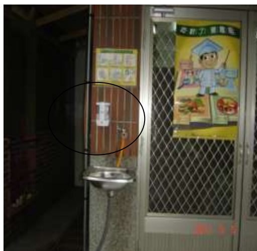
廚房門口安裝洗手設備-自動給皂液(改善後)
